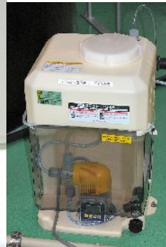
塩素注入装置
